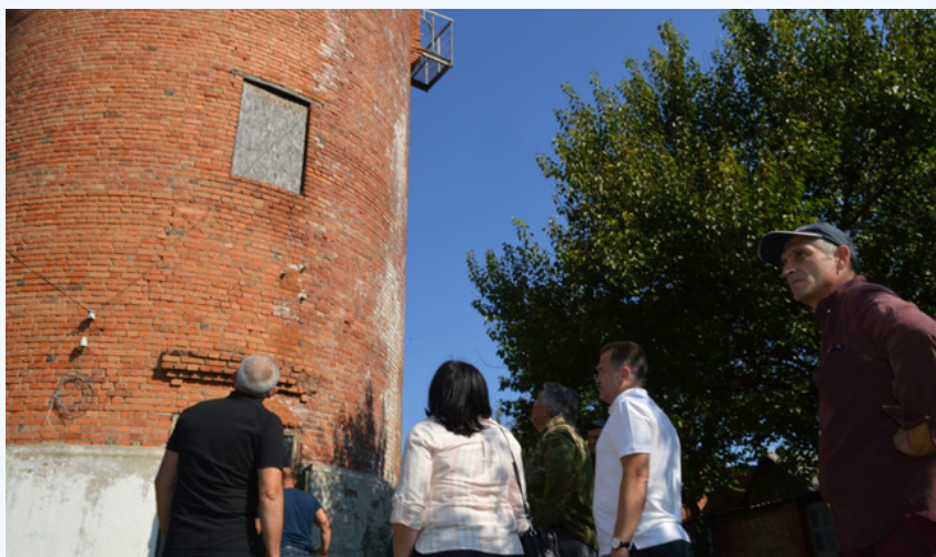
Château d'eau défaillant à Zolotchiv
